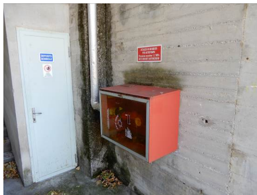
Foto 22: Vista dell'attacco per la motopompa dei VV.F. UNI 70
