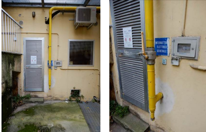
Foto 17: Vista della valvola generale di intercettazione del gas metano della centrale termica dell'edificio posto sulla terrazza al primo piano dell'edificio Ra
