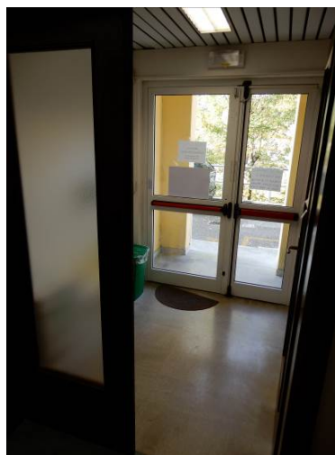
Foto 15: Vista dell'uscita di sicurezza della porzione di edificio "R" al piano terra
