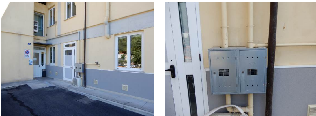
Foto 18: Vista delle valvole di intercettazione gas uso "becchi bunsen" per la porzione dell'edificio R e Ra.
